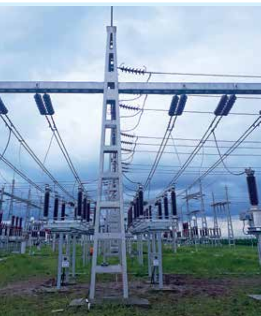
Растављачи за даљинско управљање на ТС Зрењанин 2
