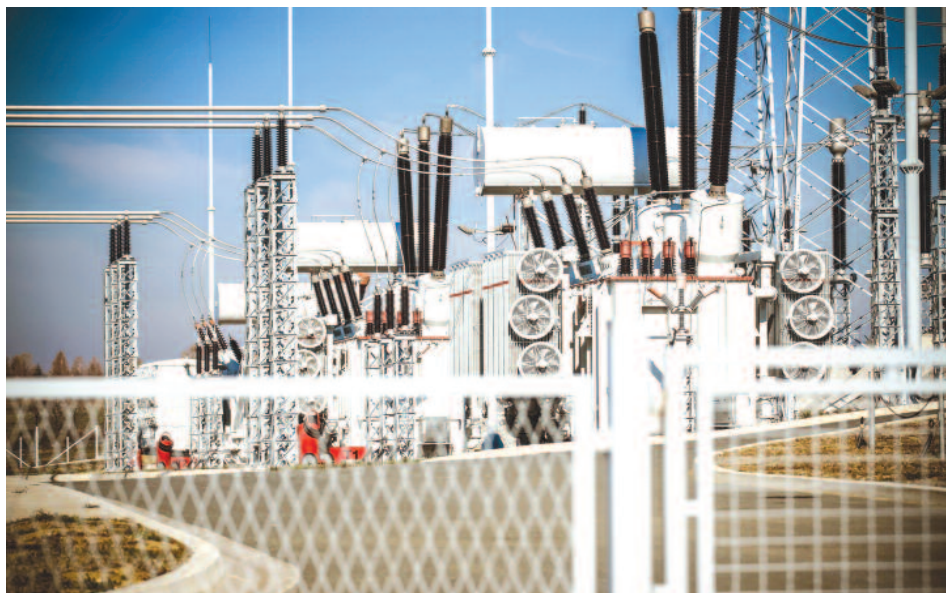
Само у 2015. години у EMC-овим трафостаницама уграђено пет нових трансформатора укупне снаге 1.600 MVA
