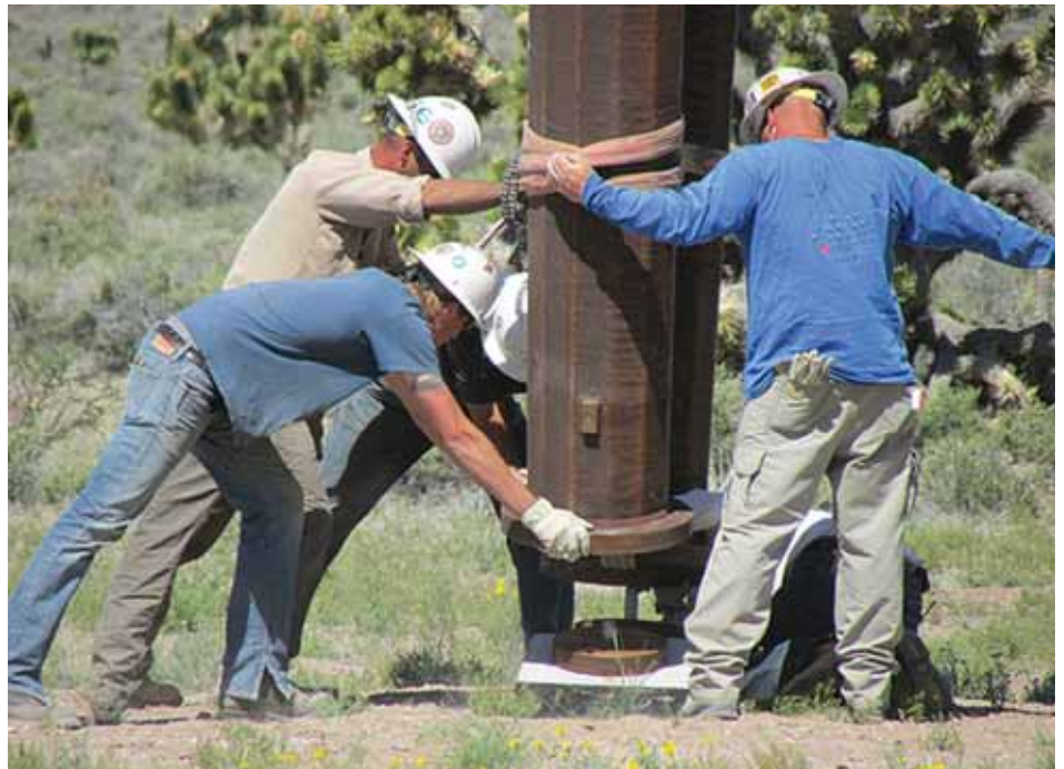
Захваљујући конструкцији која користи подешену силу затезања затега (која делује надоле), стубне конструкције далековода ON Line ослањају се само на конвексне плоче које су фиксиране са две 6-инчне болце које улазе у отворе на доњим деловима две ноге стуба.
