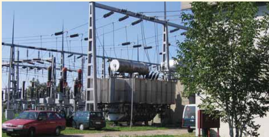
Реконструисана ТС Београд 9
